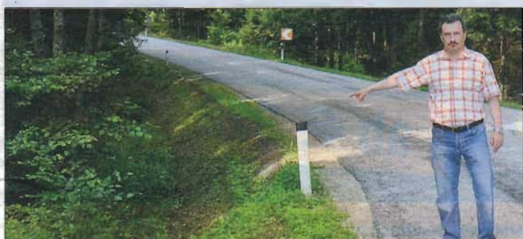
Um die Verkehrssicherheit auf der Landesstraße zwischen Brand und Thaures sorgt sich Ing. Oswin Huber, Kommandant-Stellvertreter der Feuerwehr Thaures. FOTO: LOHNINGER
